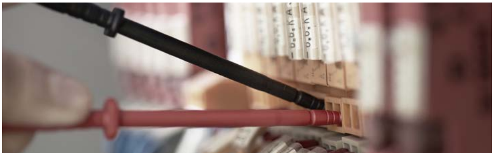
Messungen in Sicherungskästen und Schaltschränken
